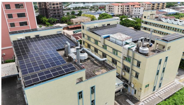
公司光伏使用现场照片
