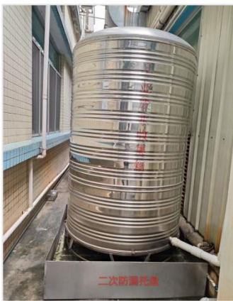
工业污水收集箱
