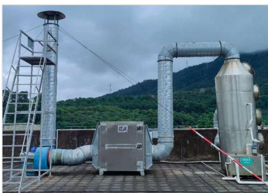
废气处理设施
