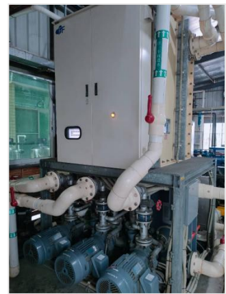
节水设施: 二次冷却设备
