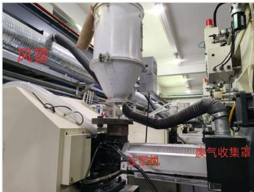
废气回收系统
